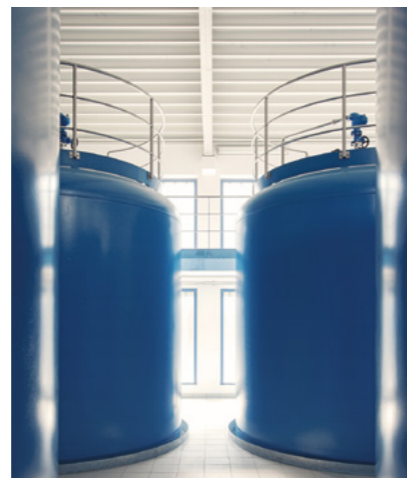
14_Filteranlage neues Wasserwerk St. Leon-Rot
