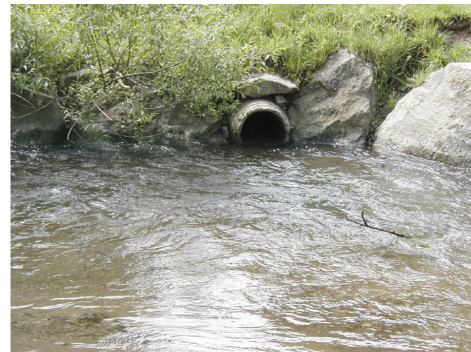
Im Zuge der europäischen Wasserrahmenrichtlinie sollen die Einleitungen aus Bauwerken der öffentlichen Kanalisation besser überwacht werden, um eine nachhaltige Bewirtschaftung der Gewässer zu erreichen
